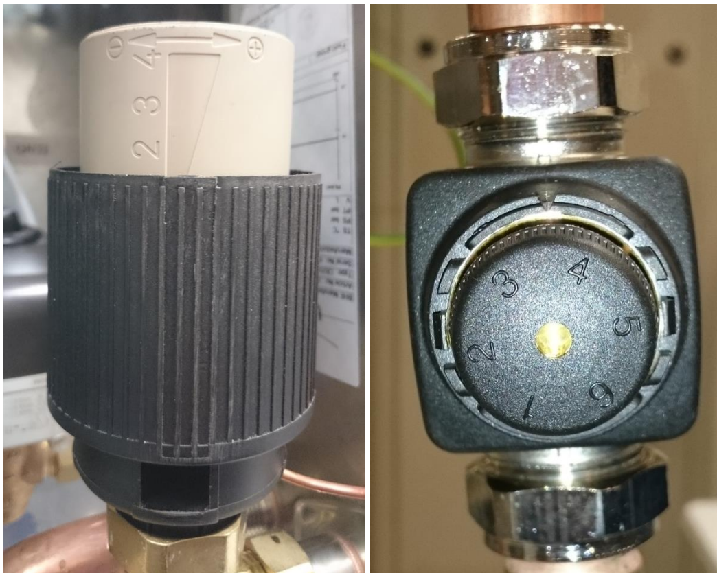
Figur 2. Varmvattenregulatorns (vänster) samt blandningsventilens (höger) inställningar för dynamisk provning.
