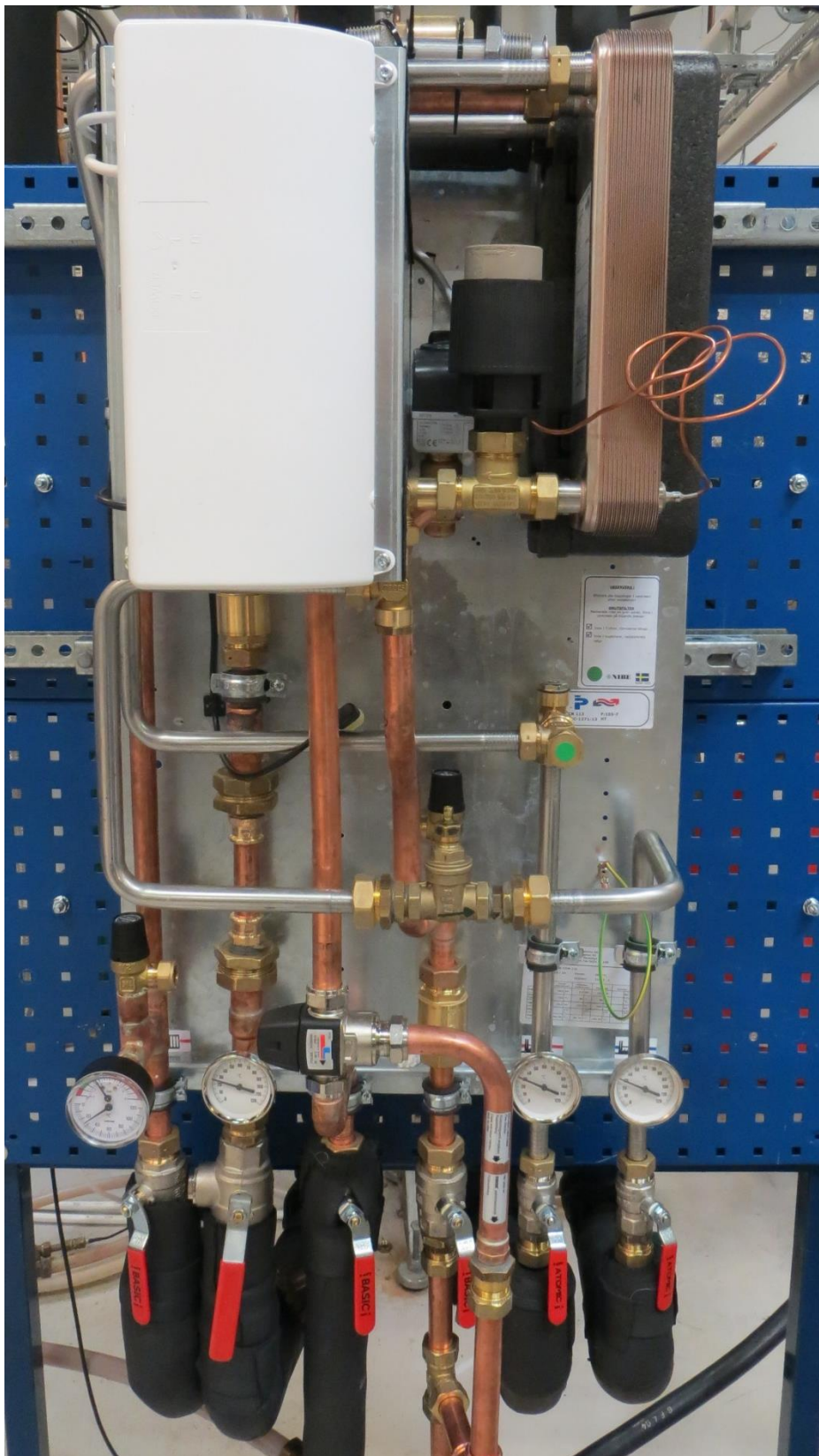
Figur 1. Fjärrvärmecentralen vid provning.
