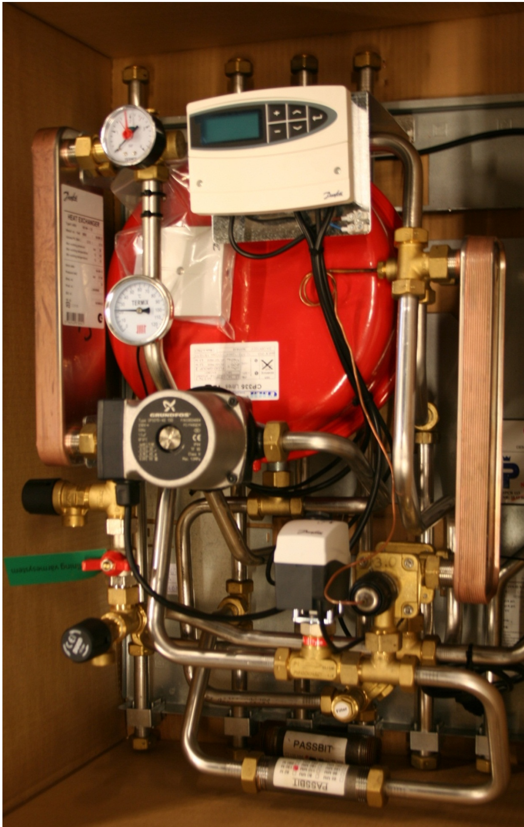
Figur 1. Fjärrvärmecentralen Gemina Termix VVX-ID 22-22 Sverige
