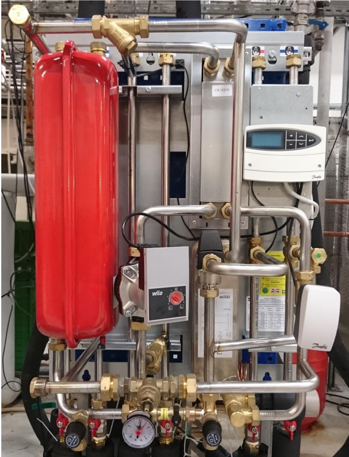
Figur 1. Fjärrvärmecentralen under provning.
